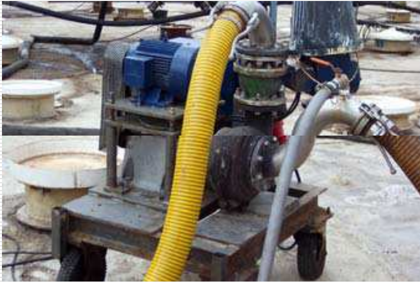
Pompe pour le transport des olives dans leur saumure
